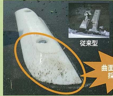
損傷状況を確認して形状決定
